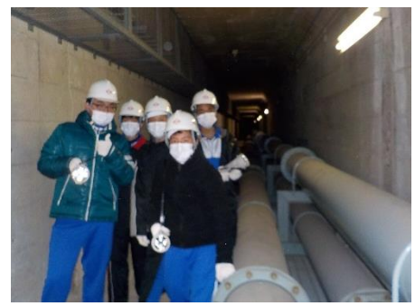
<南部下水道センター>
