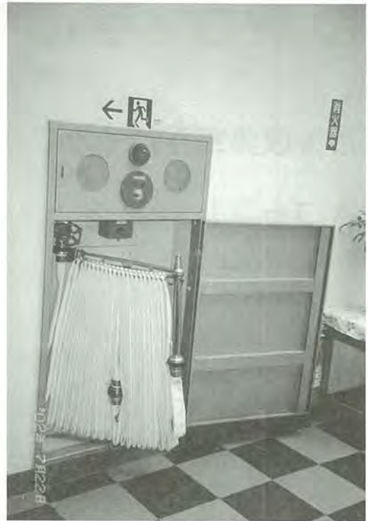
〈消火せんと火災ほうち器〉 長いホースがあります。
